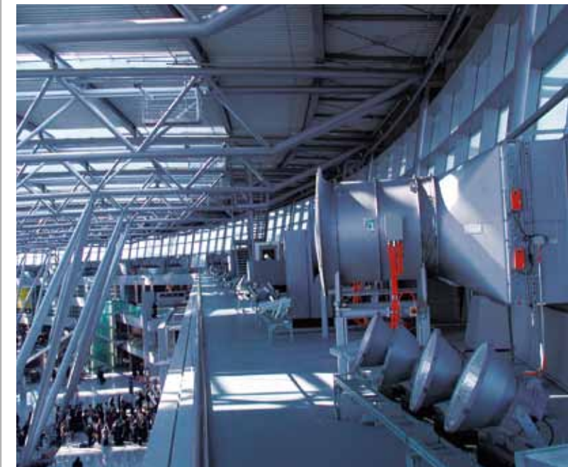
Entrauchungsventilatoren im Flughafen Düsseldorf
