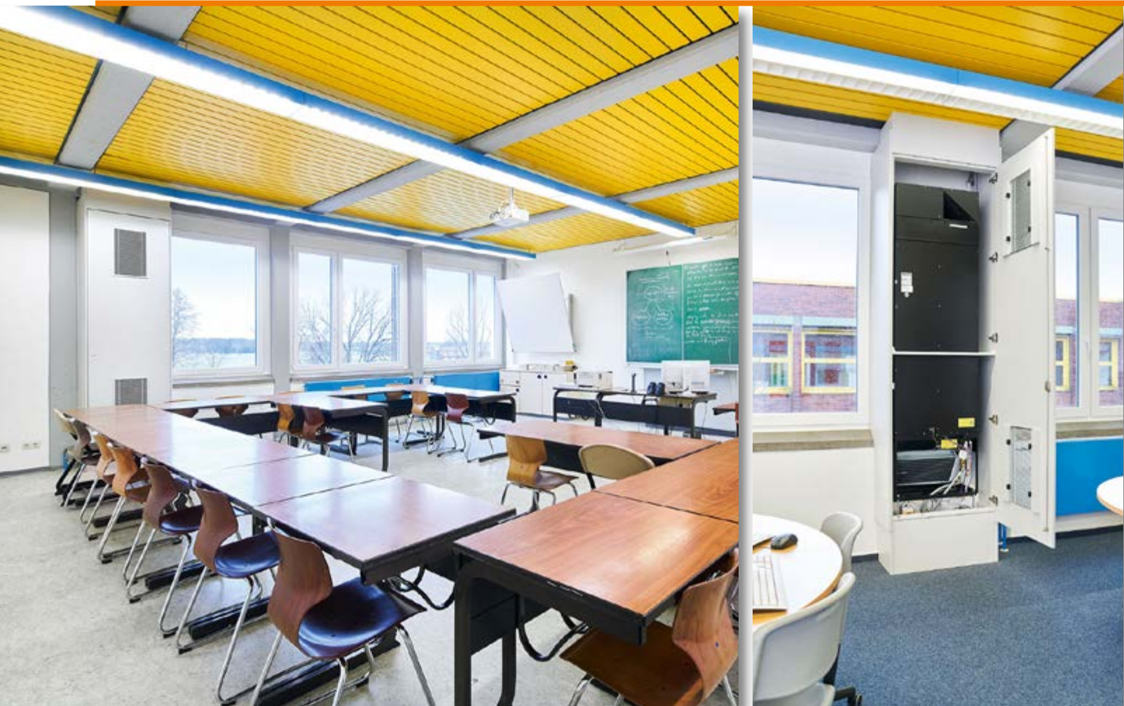
Vertikales Brüstungslüftungsgerät SCHOOLAIR-V im Paul-Spiegel-Berufskolleg Warendorf.
